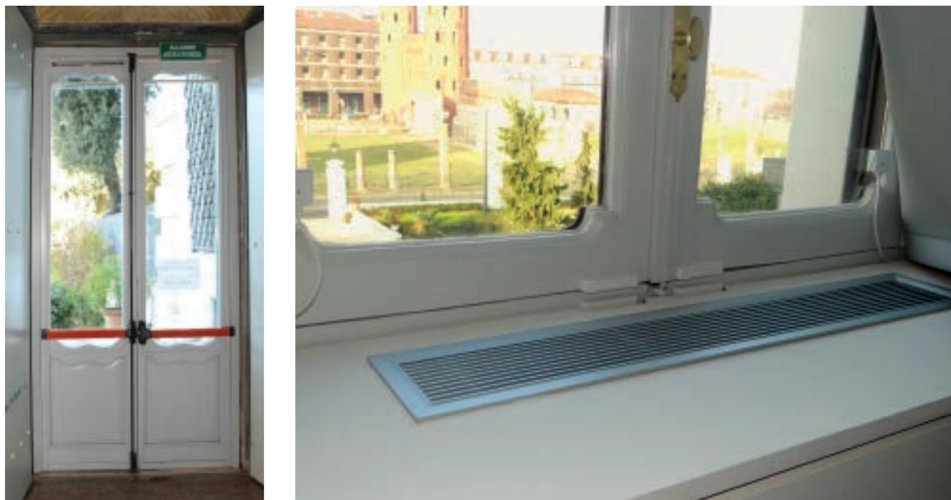
Porta e finestra con sistemi di allarme | Door and window with alarms
